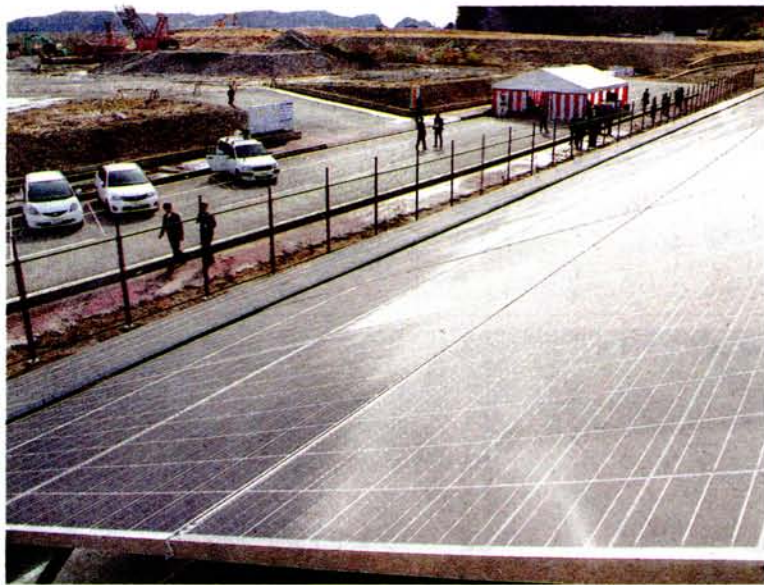
新宮港宇久井側緑地帯に設置された太陽光発電設備
